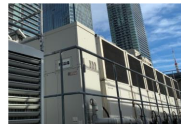
屋上の省エネ設備
